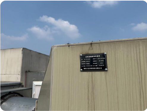
活性炭过滤装置
