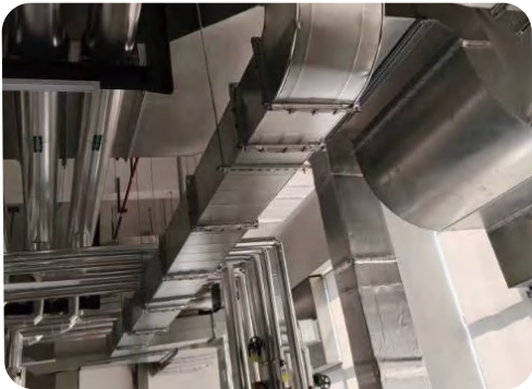
空调机组新风管路
